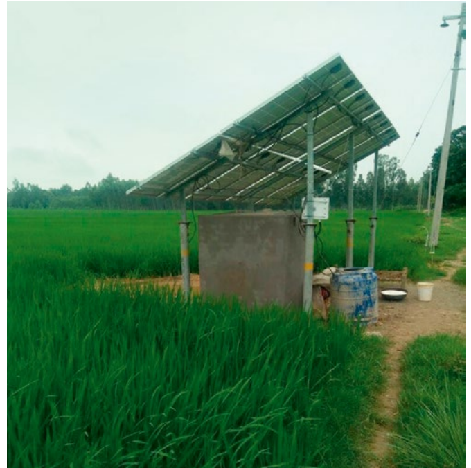
Die solarbetriebene Pumpe erleichtert die Bewässerung der Felder. – The solar-powered pump provides field irrigation.
